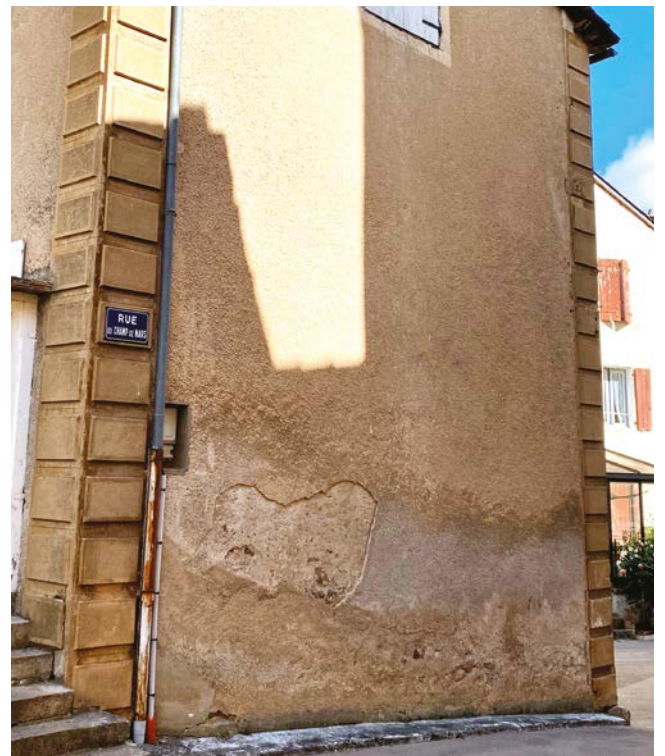
▲ Les effets des remontées capillaires sur le bas des murs
